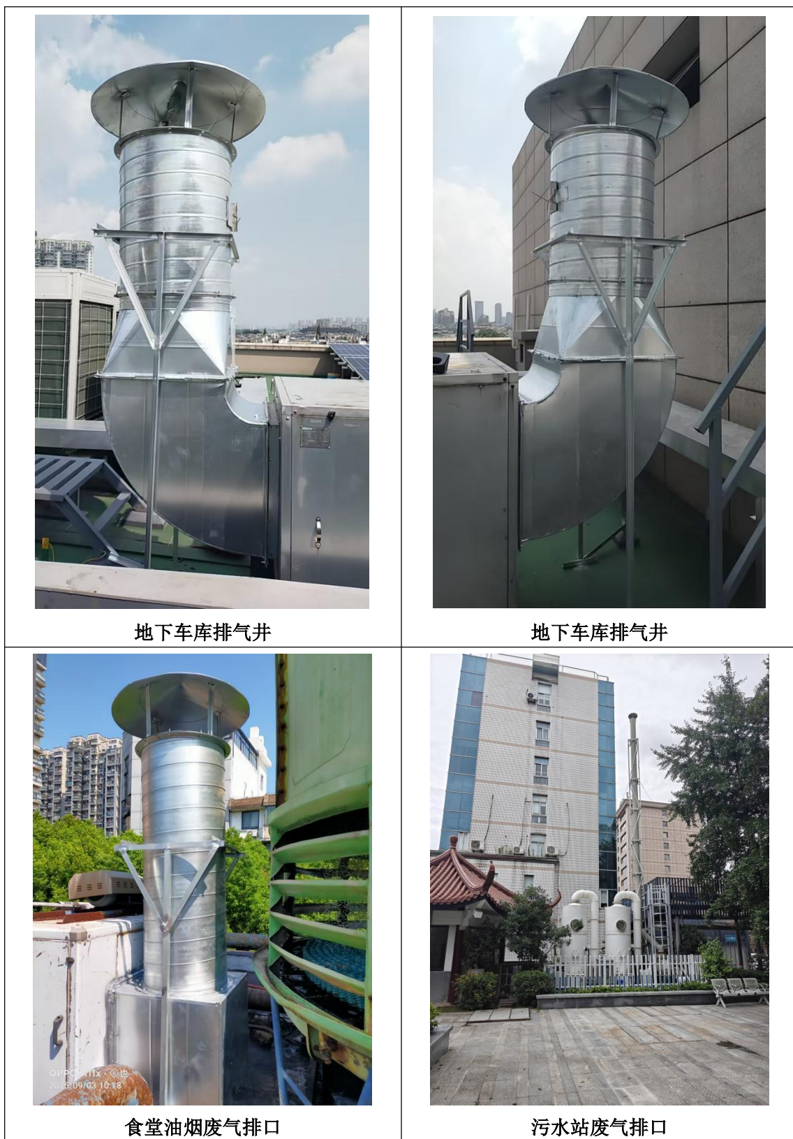
图 4.1-2 废气处理设施照片
